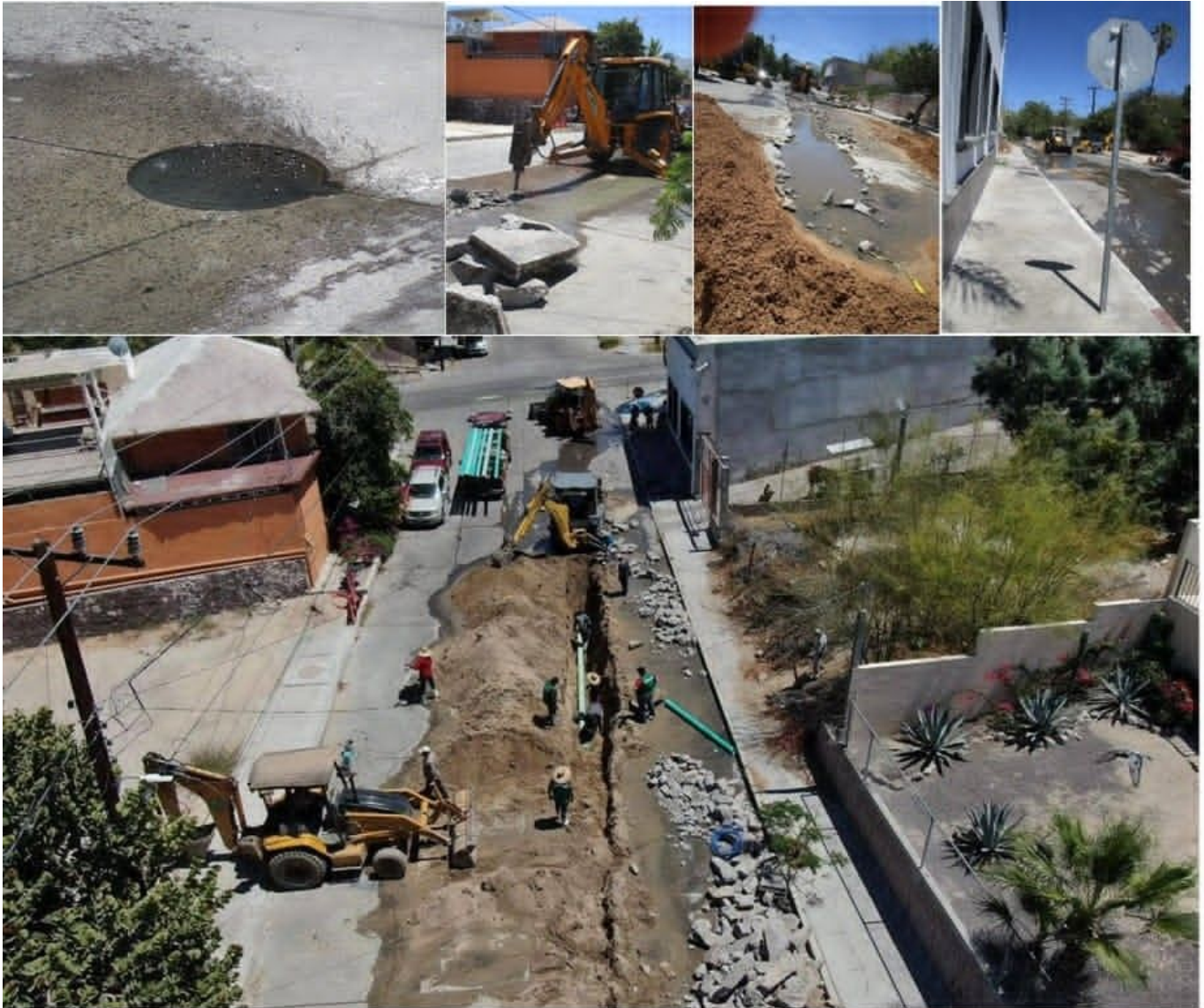
Derrame de aguas negras en el tramo de la calle Rosales entre Madero y Revolución (Foto: Gilberto Piñeda Bañuelos, 23 de abril de 2026, FB Comité de Defensa Popular, 24 de abril de 2024)
